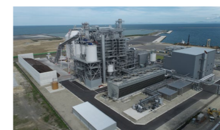
バイオマス発電プラント (刈田バイオマスエナジー(株))
