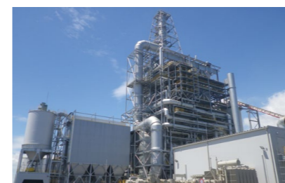
CFBバイオマスボイラ(循環流動層ボイラ)
