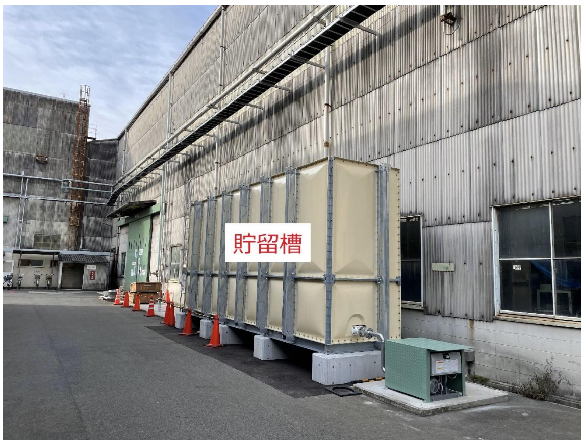
新日本造機（株）呉製作所 試験水の再利用（貯留槽）
