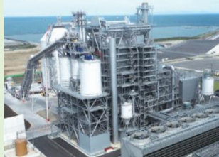
CFB/BFBボイラ発電プラント
