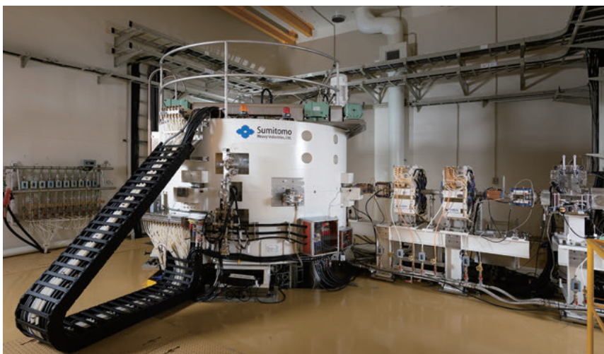
図2 新しく開発され、西条工場に設置された超電導サイクロトロン (SC230) Newly developed superconducting cyclotron (SC230) installed at Saijo Works
